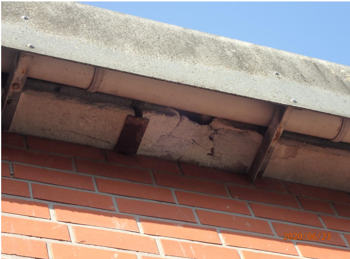
Abbildung 9: Spalten im Dachbereich
